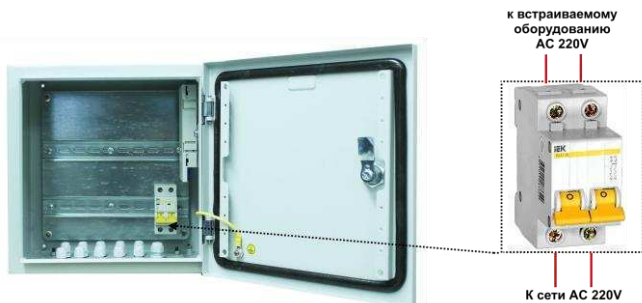
Рис. 29 Точка подключения встраиваемого оборудования в уличной станции (коммутаторе) к автоматическому выключателю 220V на примере модели OS-441
