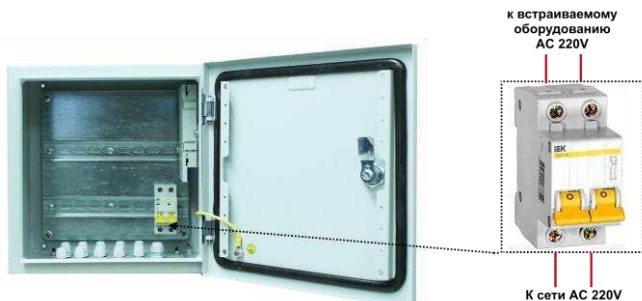
Рис. 29 Точка подключения встраиваемого оборудования в уличной станции (коммутаторе) к автоматическому выключателю 220V на примере модели OS-441
