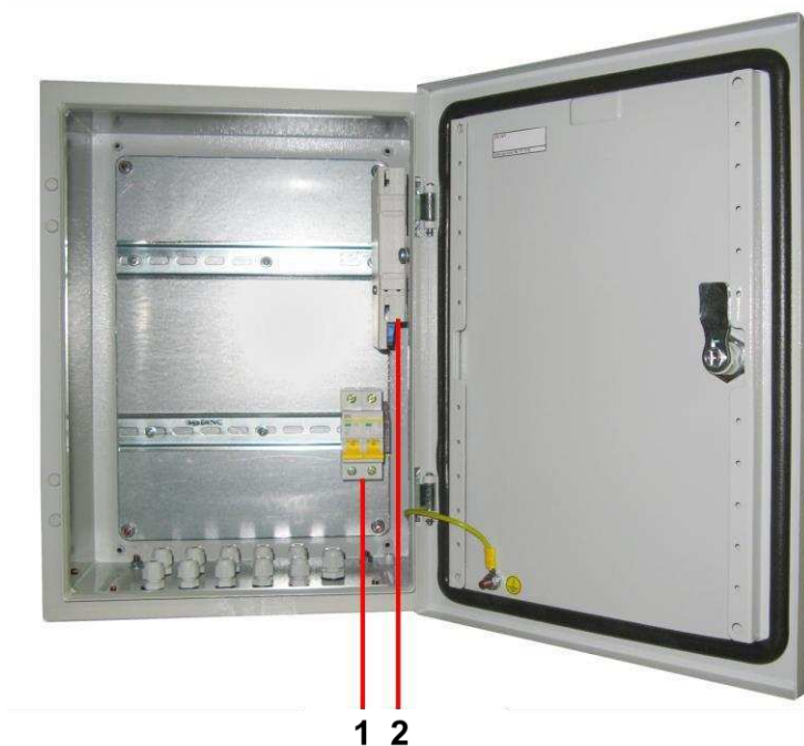
Рис.23 Уличная станция OS-341, внутренние элементы
